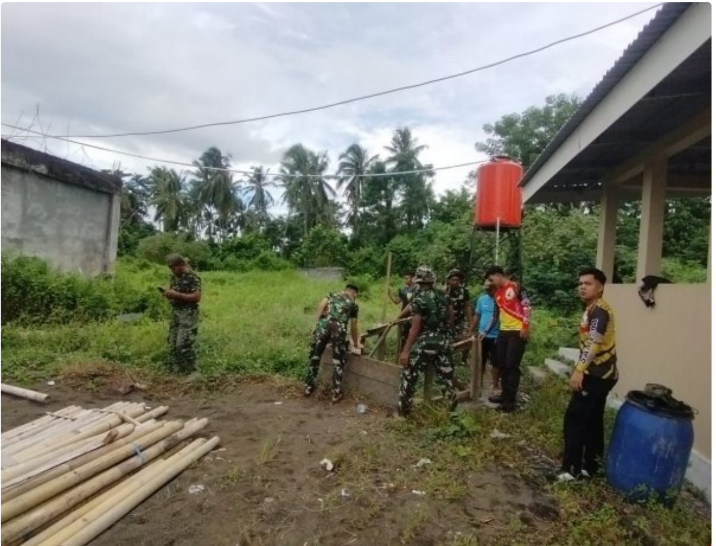
Satgas TMMMD Ke-123 Kodim 1310 Bitung lakukan pekerjaan Rehab ruang kelas Panti Asuhan Hidayatullah Bitung
