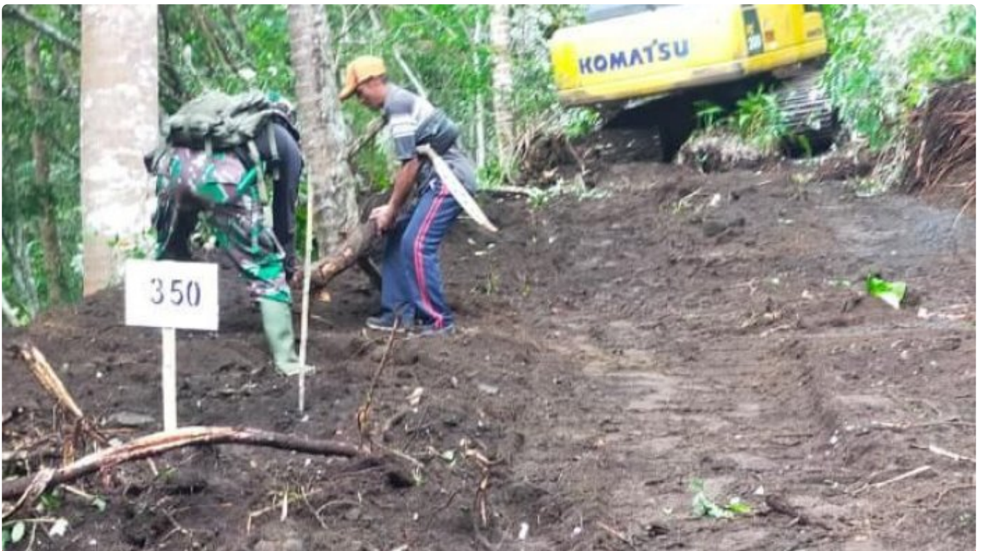
Pembukaan Akses Jalan oleh Satgas TMMD Ke-116 di Kelurahan Tandurusa. capai 350 Meter
